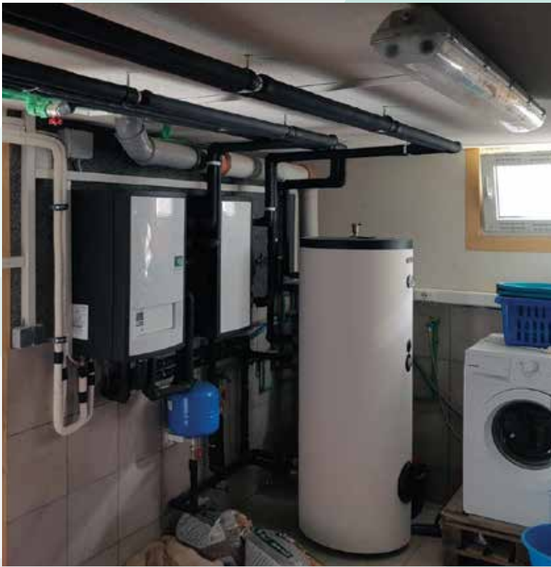
Nova instalacija grijanja i tople vode
