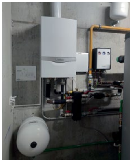
Kotlovnica ispod tribine za sunčanje
