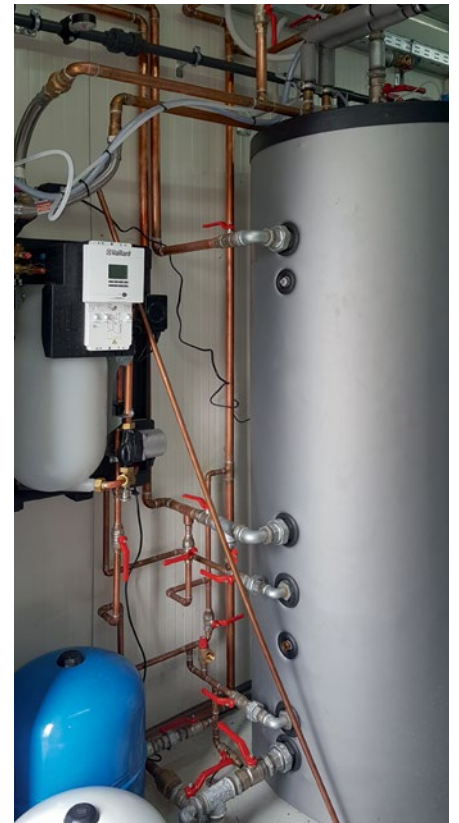
Autopraonica u mjestu Bizovac - VPM 15D drain-back solarna podstanica
