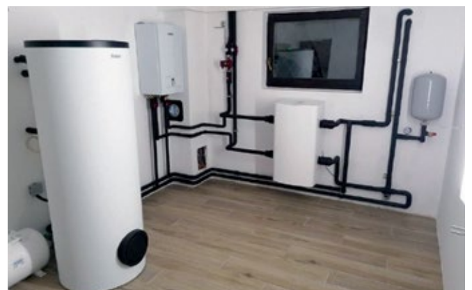
Instalacija dizalice topline
